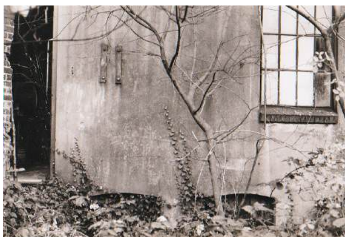
Aan de twee kelderramen kun je zien dat de grond in de tuin ruim een meter is omhooggekomen.
