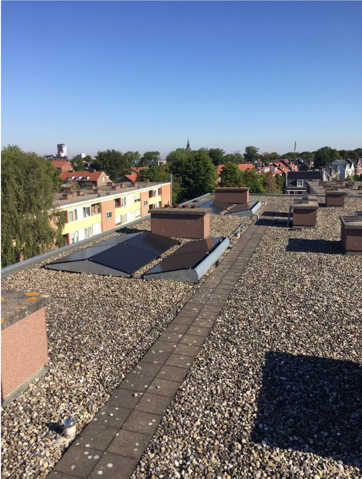
Zonnepanelen op het dak van de Prof. Hoogveldstraat 5 en 11
